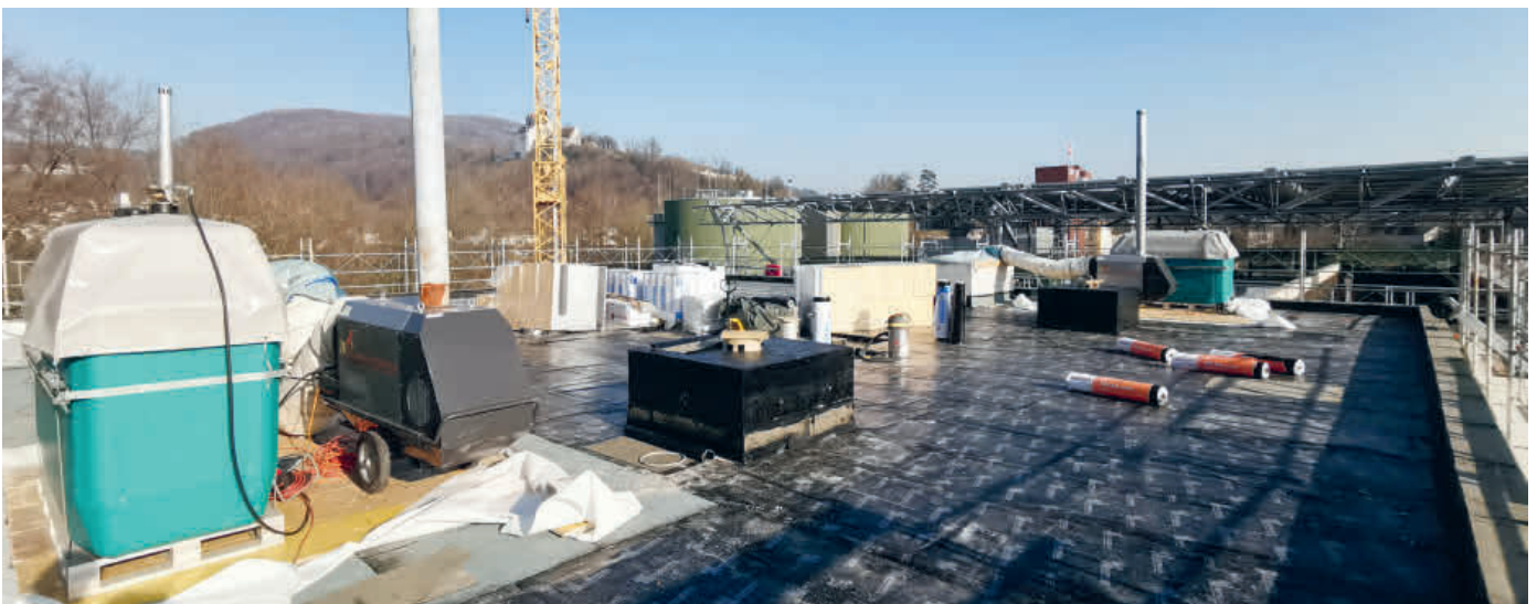
Um einer eventuellen Strommangellage gewappnet zu sein, wurde das Gebäude mit mobilen Ölheizungen statt mit Strom beheizt. Das milde Wetter unterstützt.
